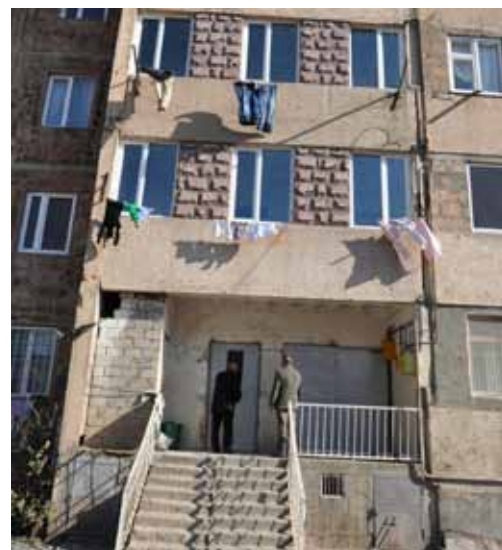
Новые хорошо изолированные окна сохраняют тепло в помещениях.
